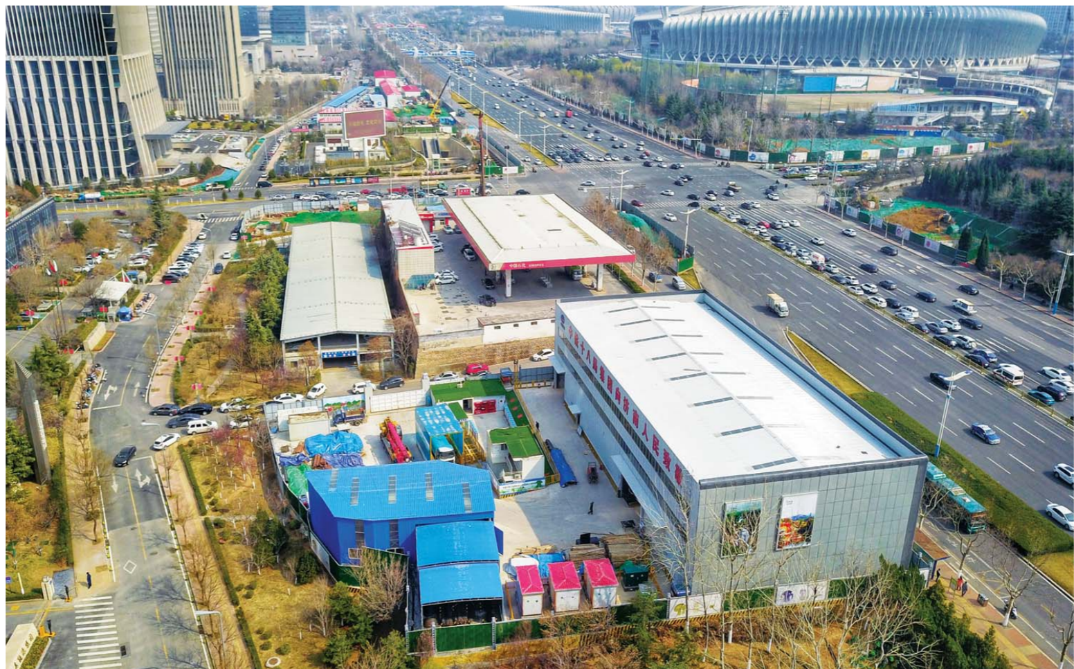
近日，经十路4号地铁全线开工建设。为减少施工带来的扬尘污染，济南首次使用“全封闭绿色施工棚”，这种超大号“方盒子”把露天作业变为室内施工，最大限度地降低恶劣天气的影响，提高了建设效率，能够大幅减少扬尘，真正实现“绿色施工”。
