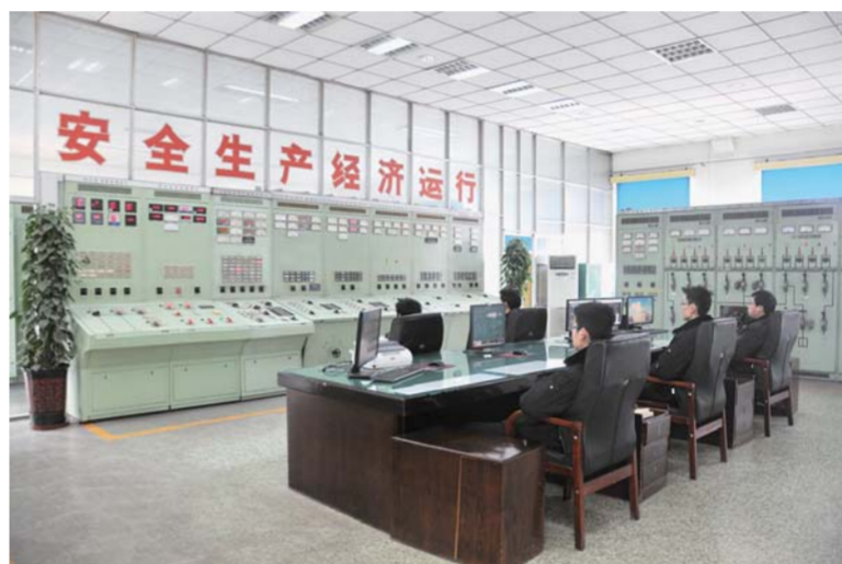
△智能化控制室
