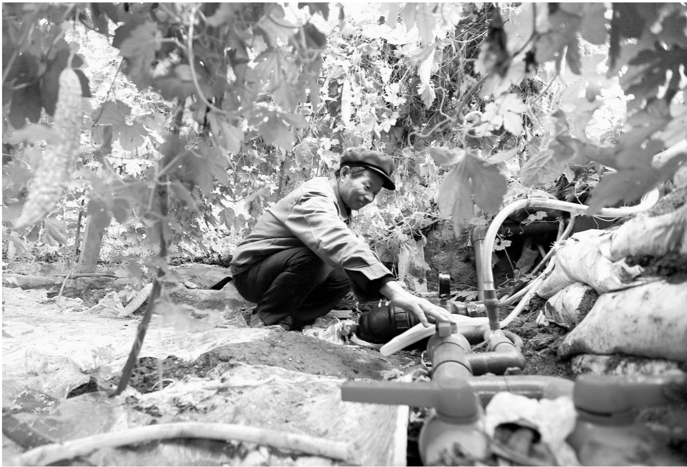
11月26日，在孙家集街道张家寨子村村民张金林的大棚内，新安装的微滴灌设备正在进行调试。
