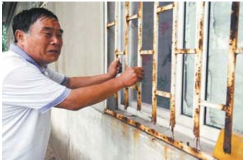
学校办公室的金属窗框年久失修，许多连接处已经锈烂断开。
