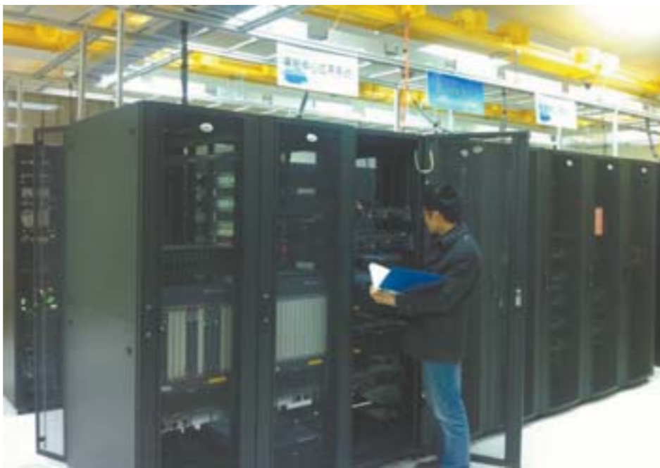
在云平台机房,工作人员正在检查服务器。
