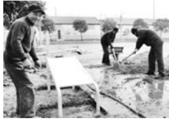
2月21日，枣庄市薛城区陶庄镇小武穴村村民在高兴地安装健身器材。目前，全镇32个行政村全部建有健身娱乐场所，村民可以像城里人一样强身健体，乐享文化生活。
