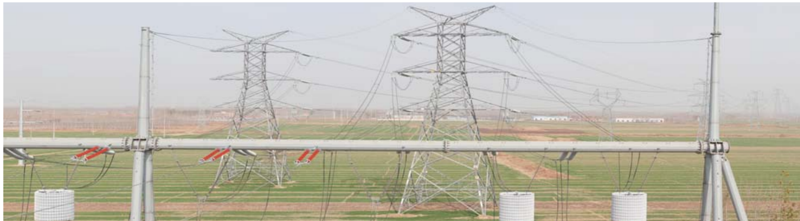
△商河变电站扩建工程现场，工程完成后将满足德大电气化铁路和商河县负荷快速增长的需要。
