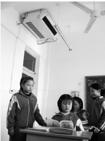
王舍人第二实验小学抽取地下水取暖。这是教室内安装的风机。 记者 丁捷 摄
