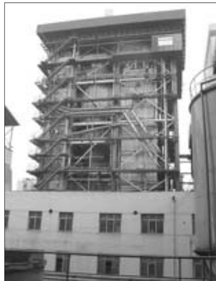
▲北部热电厂拥有全市最大的供热锅炉。
