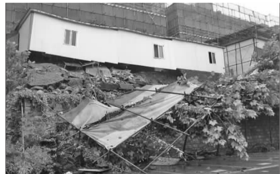
▲板房下部分地方已经悬空。 本报记者 刘铭 摄
