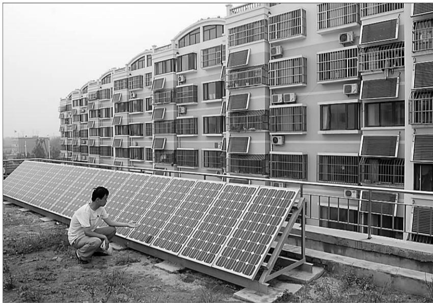
小区的太阳能光伏发电板和挂在窗下的集热器。 本报记者 王传胜 摄
