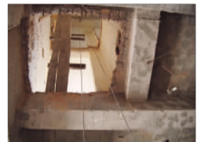
被破坏的楼板和承重墙。 本报记者 苑菲菲 摄
