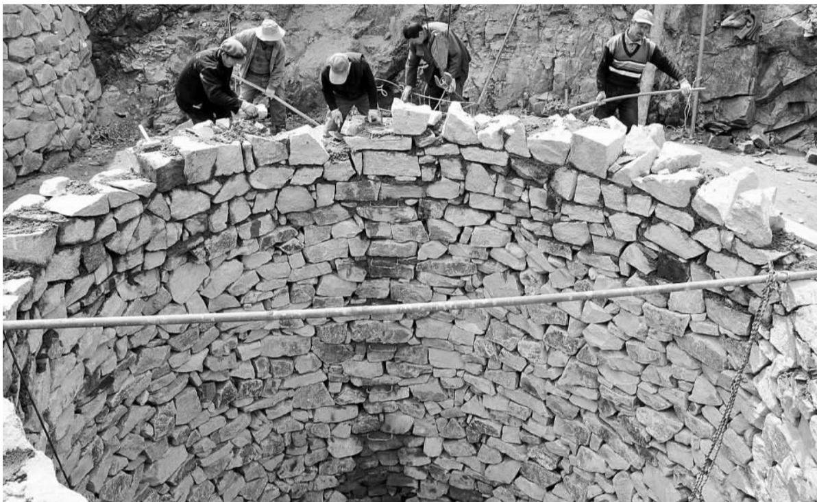
19日,乳山市的水利工程建设工人在乳山寨镇的田间建设大口井。据了解,今年乳山市投资7500万元全面启动小型农田水利建设工程,计划分三期建设覆盖全市4个山区镇67个村庄13万亩农田的水利管网,以提高基本农田抗旱能力,确保农业安全生产。 本报通讯员 刘国贤 李杰 摄影报道
