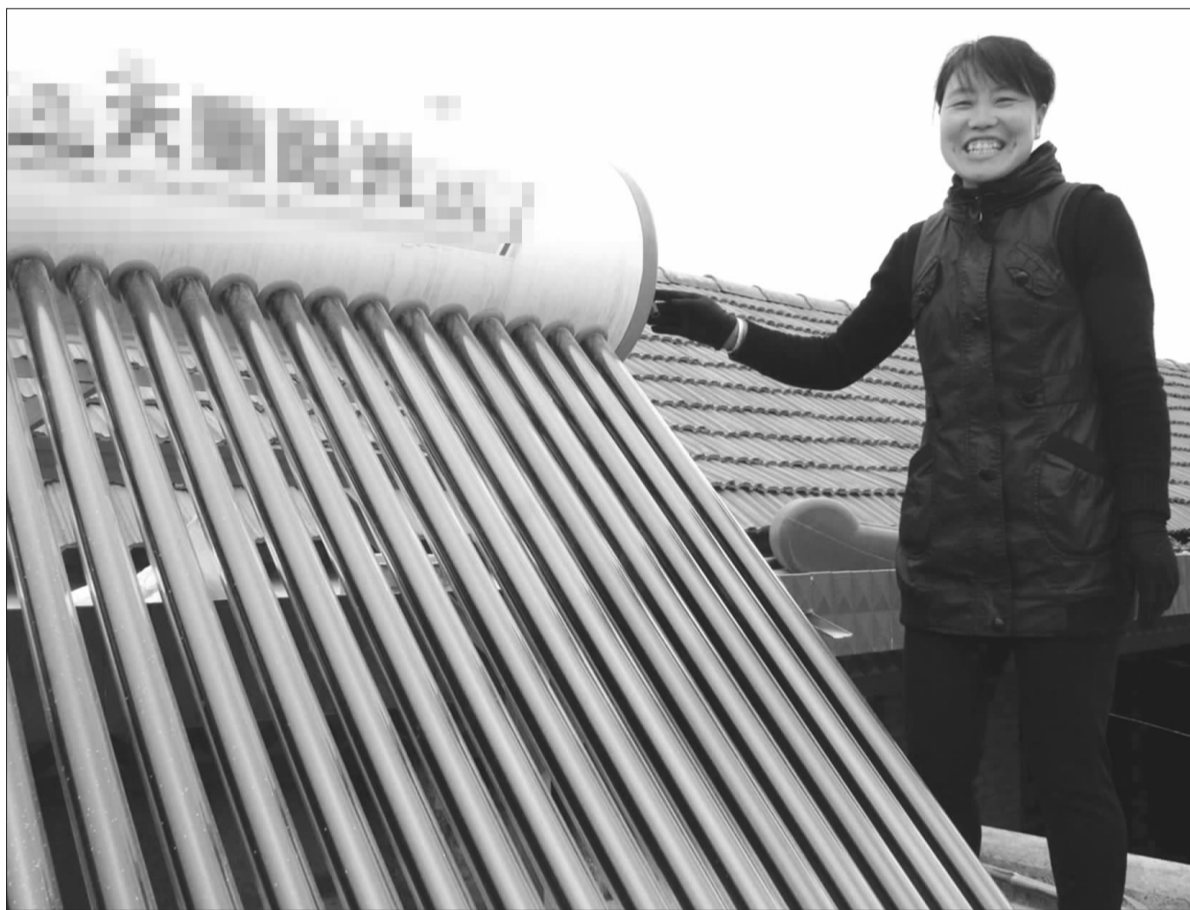
▲宏伟村村民王乐彩看到在房顶上新安装的太阳能热水器,高兴地笑了。 记者 刘海蒙 摄
