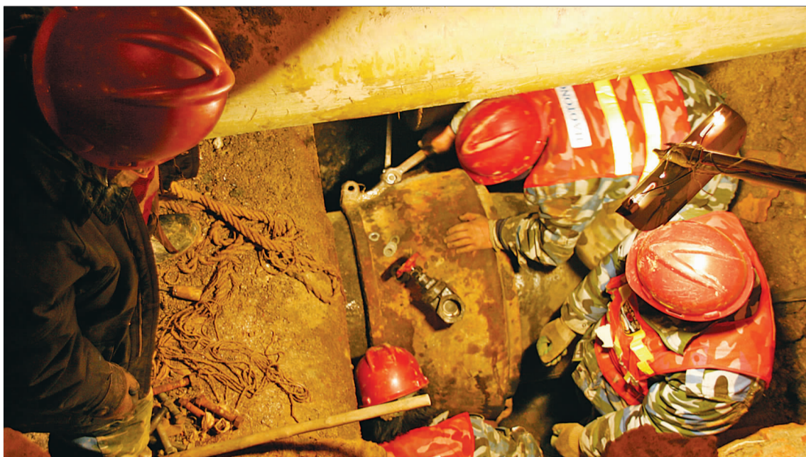
地下管线错综复杂。14日晚,工人们在狭小的空间里抓紧抢修。 照片由 李军 提供
