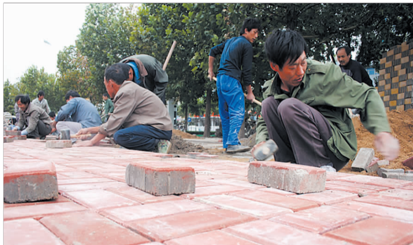
福寿街 开铺人行道
