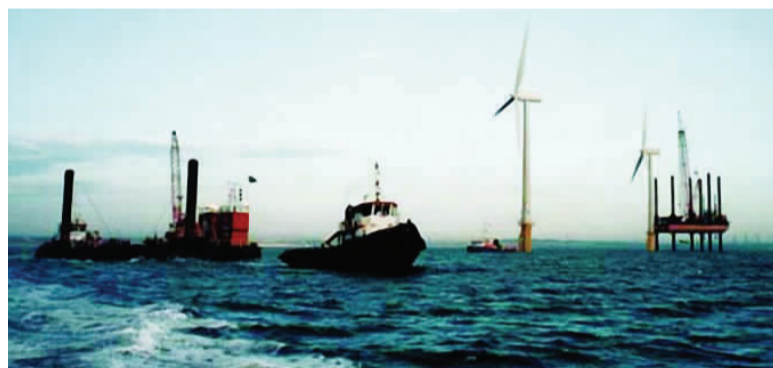
把风力发电场从陆地建到波涛起伏的大海上,这种创举将由石油巨头中海油在威海变成现实
