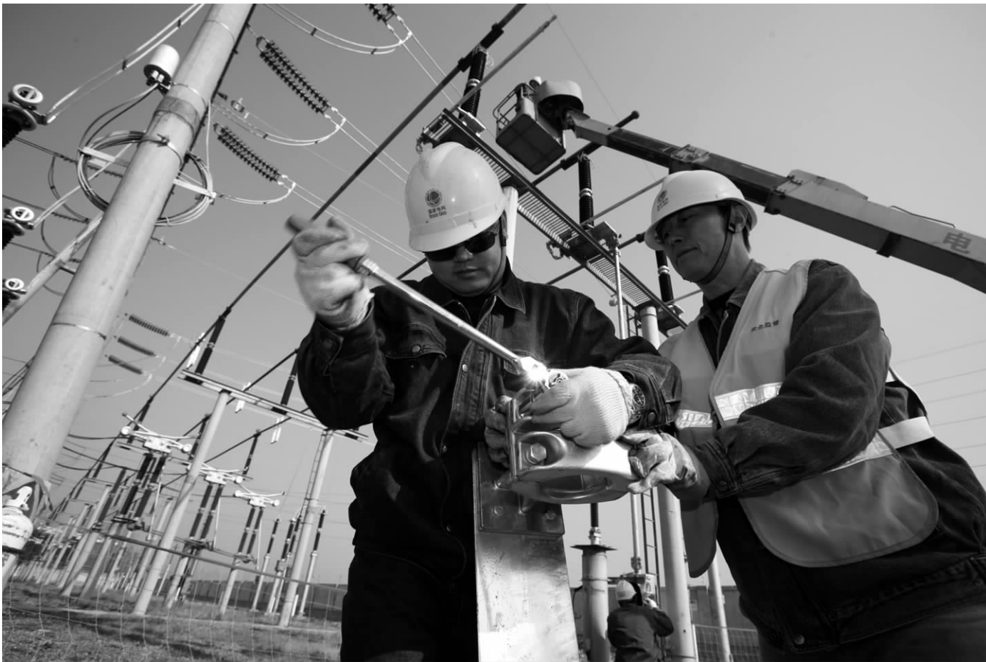
12月31日，济南供电公司济南重要变电站的设备进行特巡，确保省城居民用电无忧。
