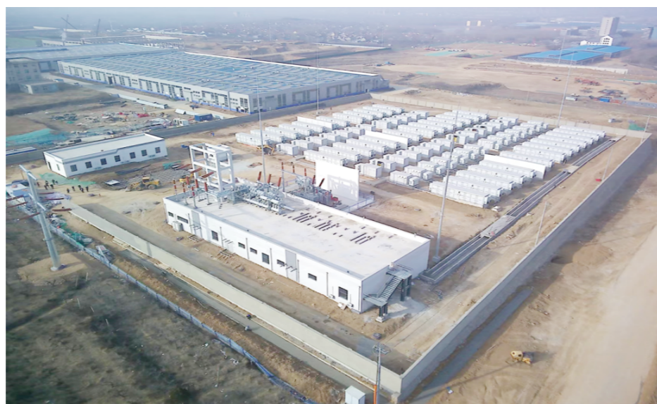
沂水300兆瓦/600兆瓦时储能示范项目。
