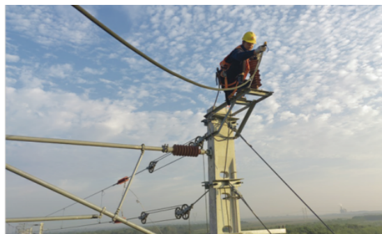
□记者 李明 通讯员 唐飞 文媛媛 报道 进入冬季，中铁十五局集团轨道交通运营公司黄大分处供电作业人员加强设备检修，消除安全隐患，确保黄大铁路供电安全。图为近日该公司员工对管内设备进行巡视检修，全面提升设备质量。
