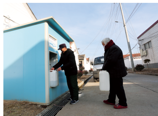
□记者 曹儒峰 通讯员 付刚 陈阳 报道 为改善村民饮水条件,泰安市泰山区邱家店镇刘家滩村和泰山区水利局近日联合筹资,在村里安装了3台净水机,并设置取水点,方便村民取水。
