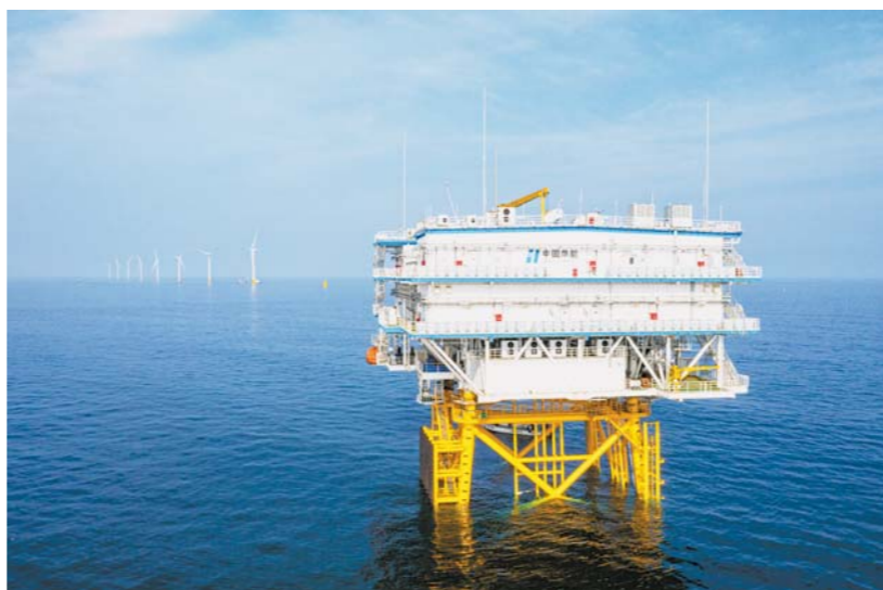
▲华能山东半岛南4号海上风电升压站
