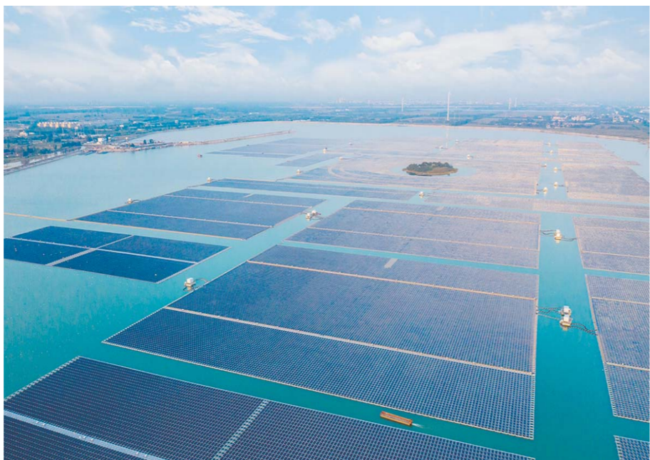
德州丁庄水库漂浮式光伏项目鸟瞰图。
