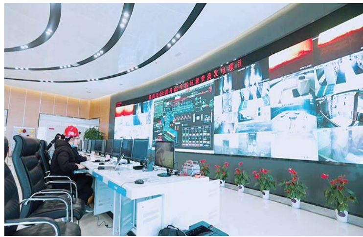
济南长清马山生活垃圾焚烧发电调度指挥中心。
