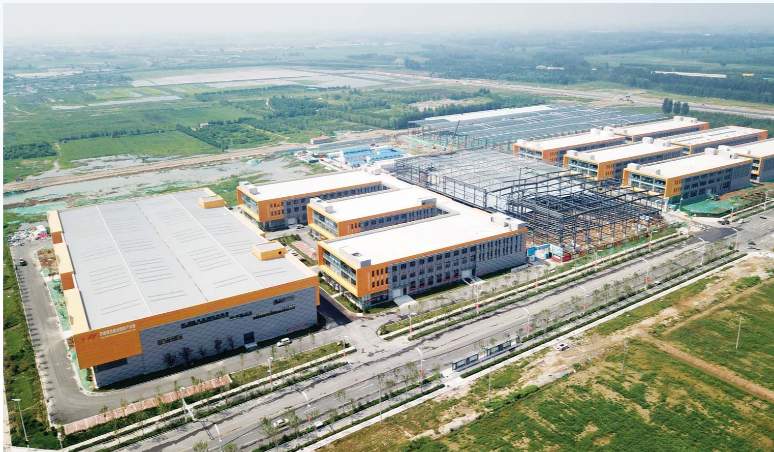
□ 记者 刘飞跃 报道 济南绿色建筑国际产业园一期一批次的8个标准厂房已实现主体结构封顶,1号构件车间和3号构件车间已经完成主体工程施工。
