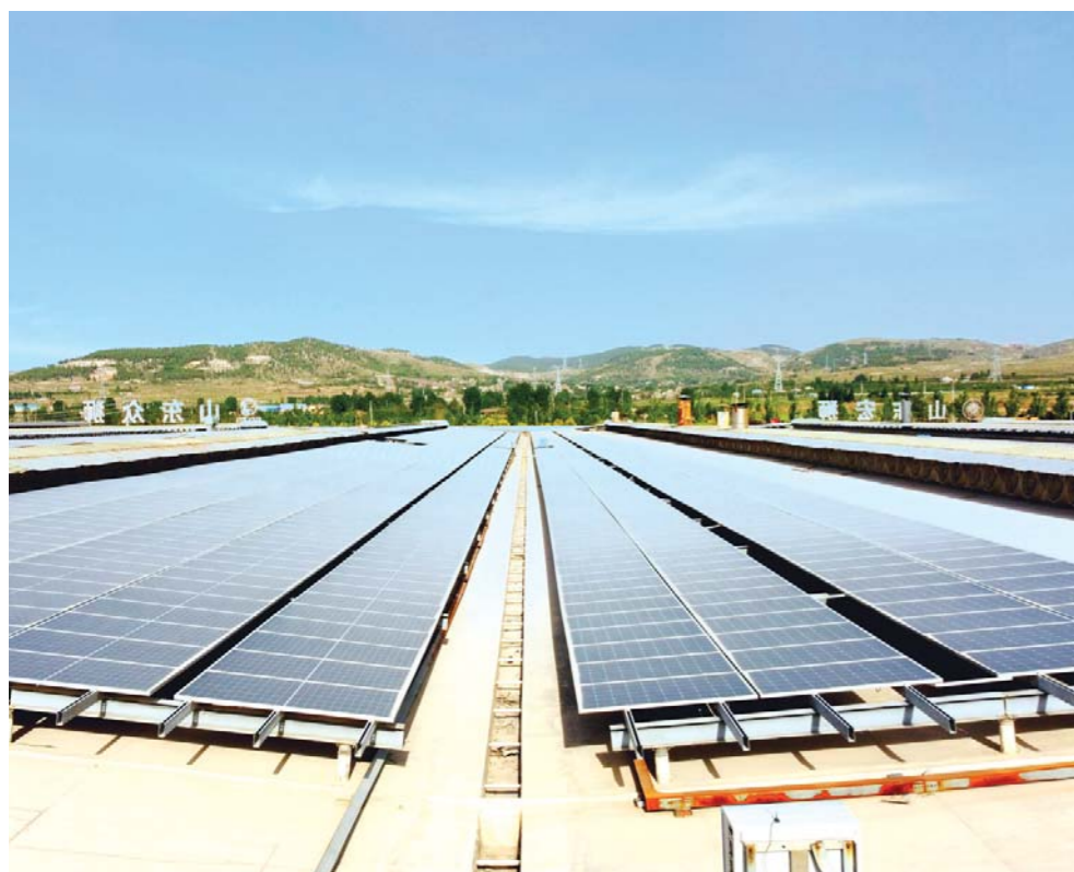
山东高速淄博建陶产业园光伏项目。
