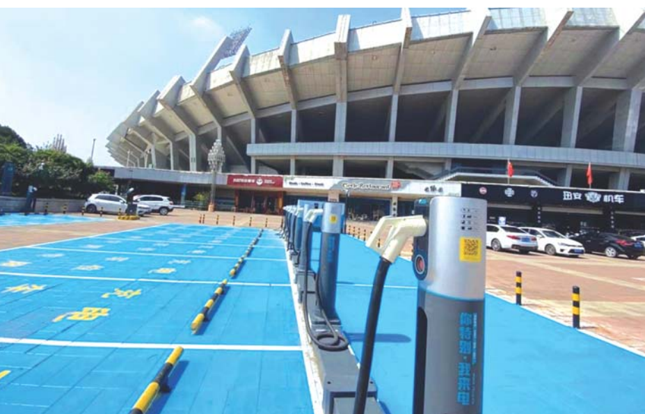
山东省体育中心新动能示范充电站。
