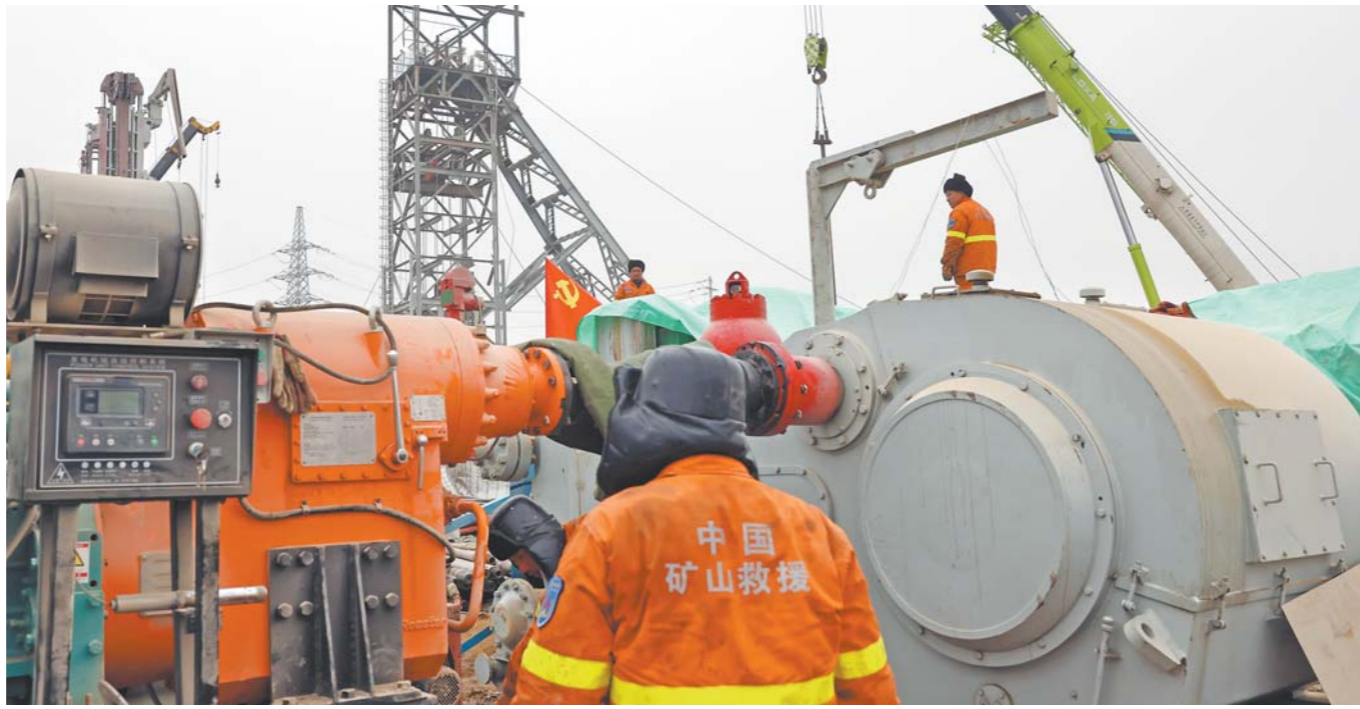
1月25日，栖霞笏山金矿爆炸事故救援现场。
