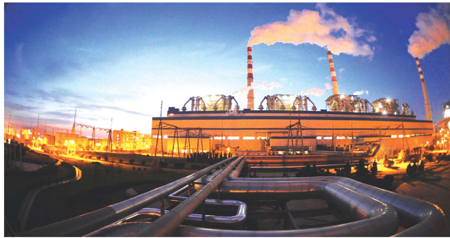
华能山东公司德州电厂供热管网。
