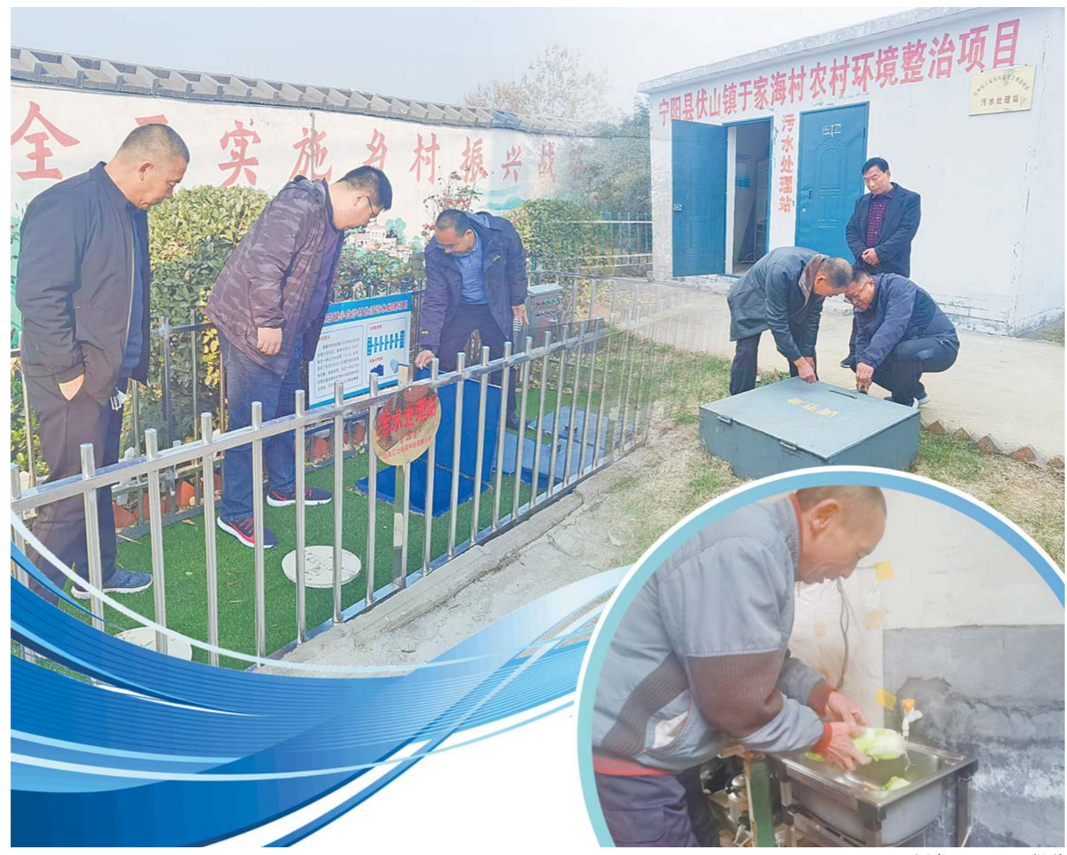
左上图：新泰市西张庄镇小白沙村建设了8处小型污水处理系统，图为小白沙村党支部书记范庆国(左一)等人查看3号污水处理站情况。右上图：宁阳县伏山镇于家海村建设的农村生活污水处理站。全村的污水通过地下管网接入处理池，通过厌氧发酵、湿地吸收等过程处理后，排放到旁边的水坑。下图：宁阳县东疏镇前张庄村将全村划分为5个片区，每个片区建设安装一个太阳能微动力的小型污水处理站，污水首先通过村民家里的滤网，较大的垃圾被过滤出去，然后通过管道进入处理站的调节池。
