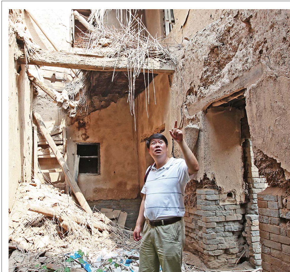
古建筑调查工作经常穿梭在古建筑古街巷拆迁现场，很危险。图为李铭冒着建筑坍塌的危险，调查济南商河县很少见的二层古民居建筑。
