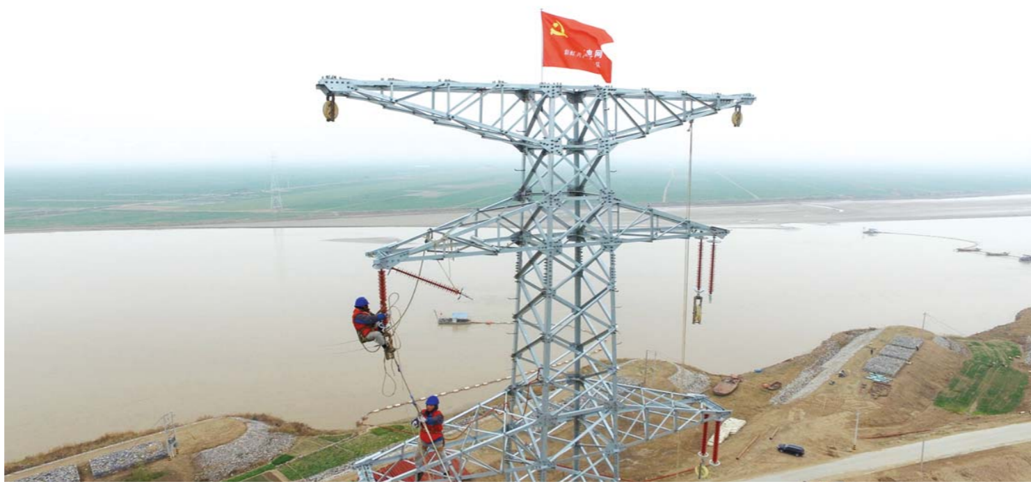
国网东明县供电公司彩虹共产党员服务队架设山东省跨度最长、单塔最高、塔身最重的跨黄河线路10千伏“润农线”。
