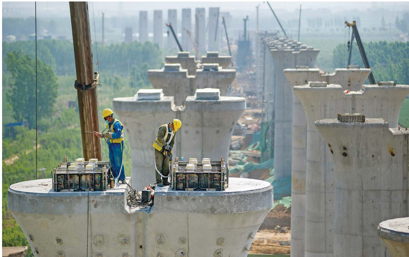
中铁建大桥局鲁南高铁湾曲段项目现场，施工人员正在墩柱上进行垫石施工。
