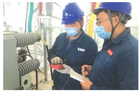
烟台供电公司工作人员正在对220千伏招远变电站相关设备进行检测。
