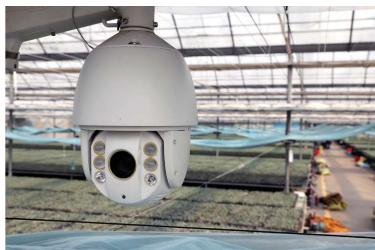
智能化温室使用的高清摄像头，它是物联网的一部分，为手机等终端传送温室内的直播影像。
