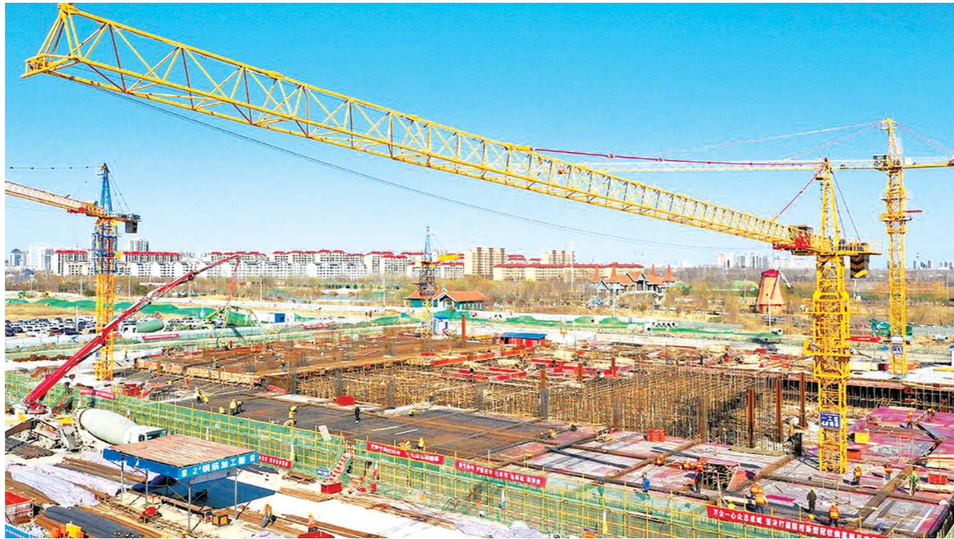
3月4日,渤海先进技术研究院(一期)项目施工现场塔吊林立,大型机械轰鸣,工人正在紧张施工。
