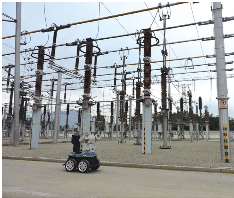
泰安供电公司应用智能机器人巡检220千伏红庙变电站。
