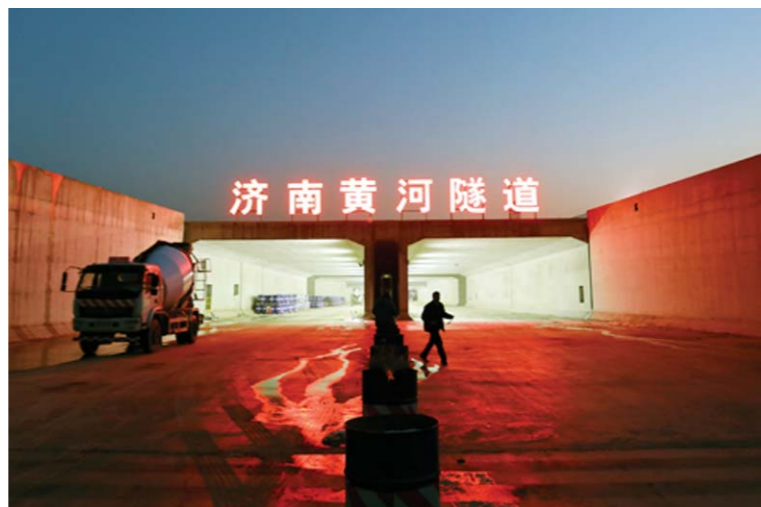
夜晚，穿黄隧道依然来回穿梭。不久的将来这里将是一片车水马龙的景象。
