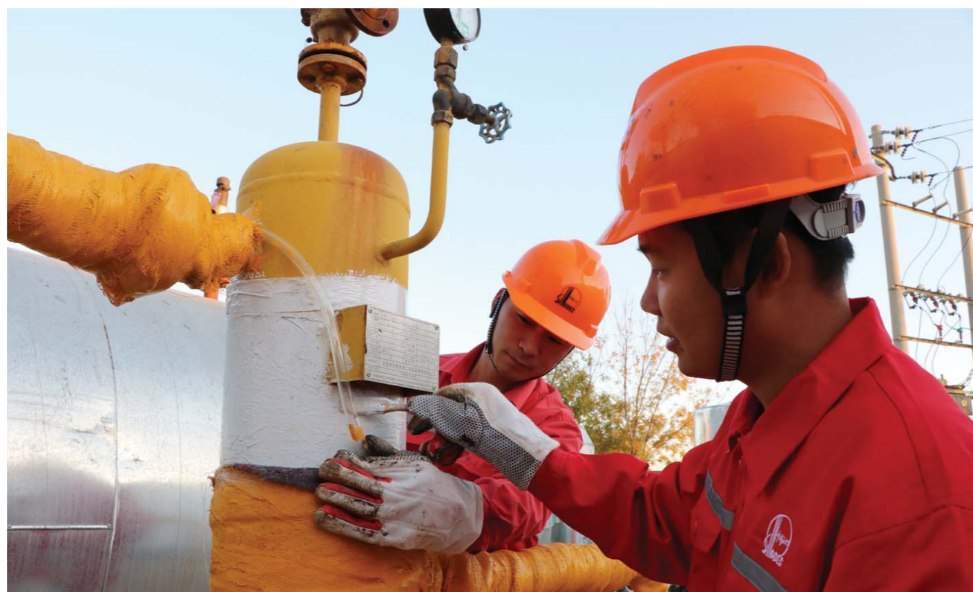
□通讯员 苗振振 报道 中石化胜利油田东胜公司河口采油管理区员工积极开动脑筋，合理利用闲置资源，通过废旧管线串联，将回收套管气传输至计量站用于加温，实现了清洁环保和提质增效同步发展。
