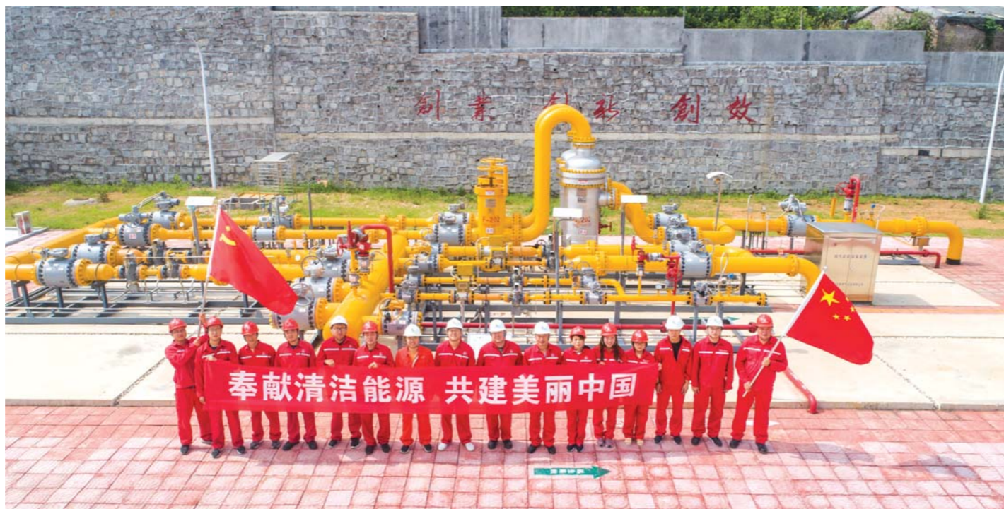
山东实华天然气有限公司日照输气站。
