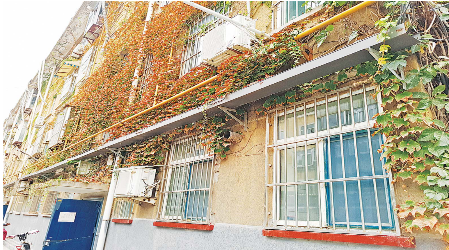
车站社区在丝厂东宿舍等老旧小区楼宇间墙壁上安装了线路通道。
