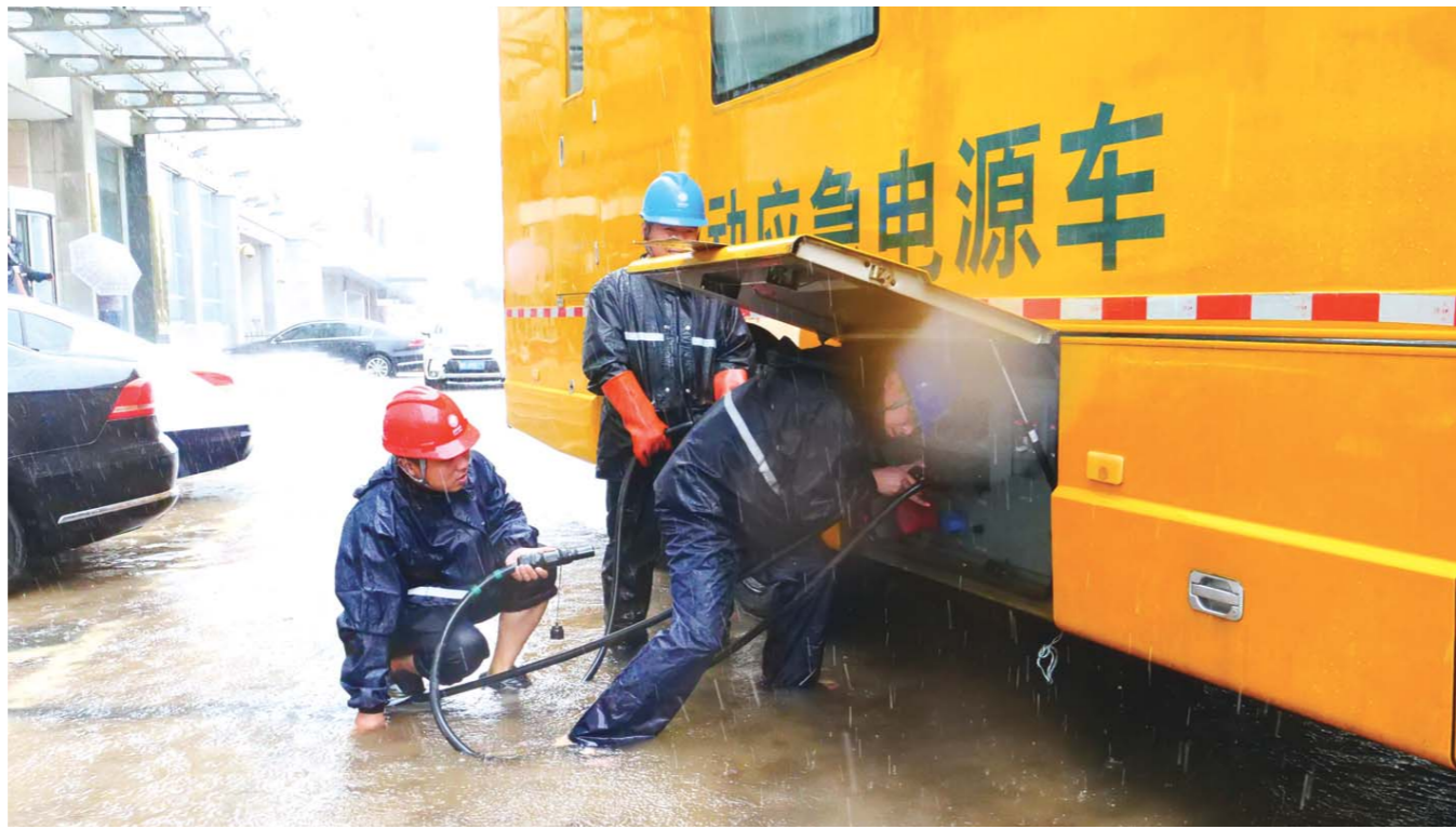
8月11日，国网东营供电公司配电检修人员对城市数字化管理中心低压开关进行检修。 □李恒发 张思凯 报道
