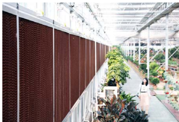
循环使用低温地下水的空调设备，为智能温室降温。
