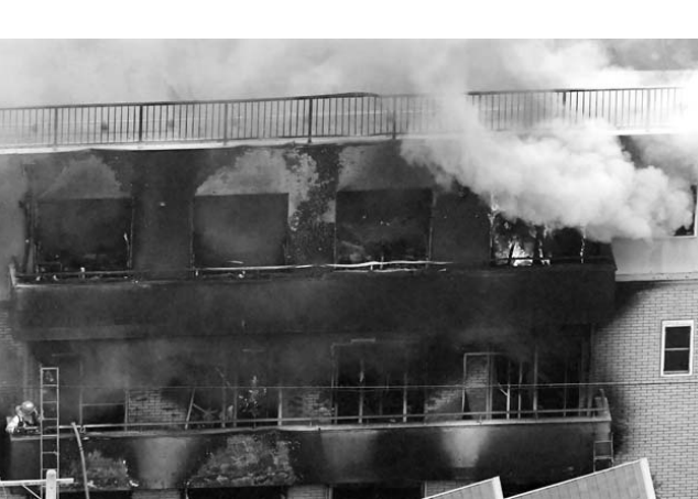
7月18日,在日本京都市,发生火灾的建筑物冒出浓烟。 □新华社/路透
