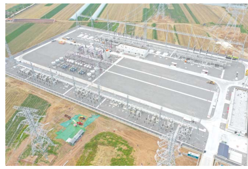
7月4日，青岛神山500千伏变电站一次送电成功，顺利建成投运。
