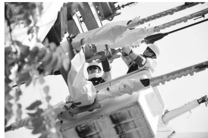
5月25日，国网平阴县供电公司带电作业班工作人员在10千伏后寨线58号杆，为济南伊利乳业有限公司扩建第二期工程线路迁改实施带电断线路引流线工作，在提高供电可靠性的同时，推进企业扩建工程进度。（郭峻峰 张楠）
