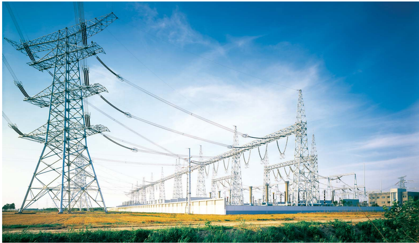
“外电入鲁”大通道1000千伏锡盟-山东特高压工程山东段
