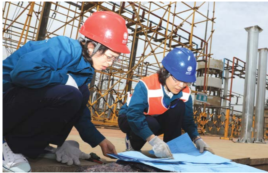
5月13日，淄博供电公司施工人员正在龙泉220千伏变电站扩建工程勘察图纸。
