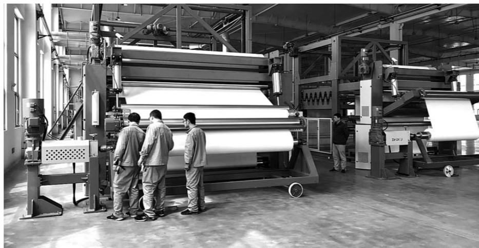
近日，位于昌乐经济开发区(宝城街道)的佳诚数码产业园投入使用。该产业园将打造全自动化智慧工厂，打通上游产业链，提供打印介质产品的认证、质检、分切、包装、仓储及物流服务。图为技术人员正在对已安装完成的设备进行调试。
