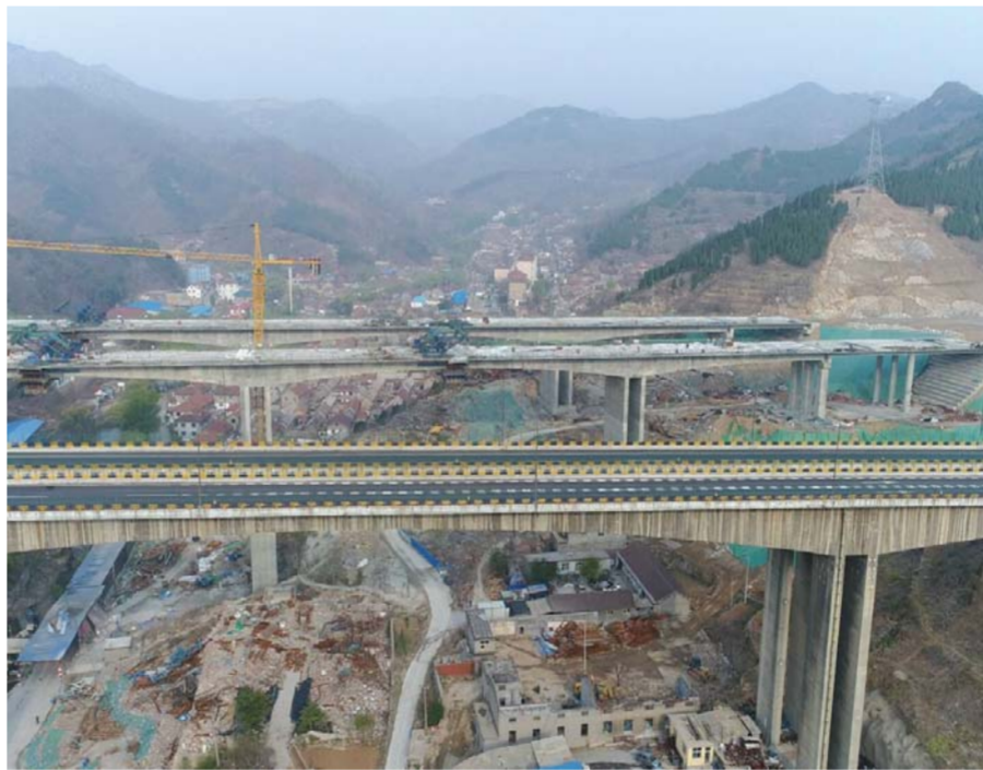
滨莱高速公路淄博西至莱芜段改扩建工程樵岭前1号大桥顺利合龙。
